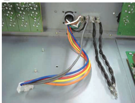
80 DCIN WIRING ASSEMBLY (DCIN束線)
