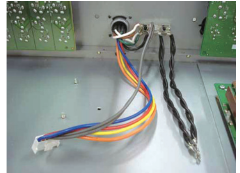
(80) DCIN WIRING ASSEMBLY (DCIN束線)
